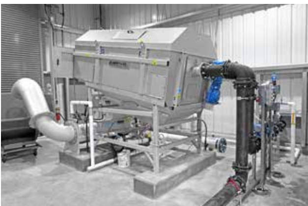
HUBER Fäkalannahmestation RotaShield® im Einsatz.
