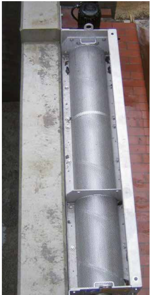
Einsatz einer HUBER Siebanlage ROTAMAT® RoK2 in einem Entlastungsbauwerk.
