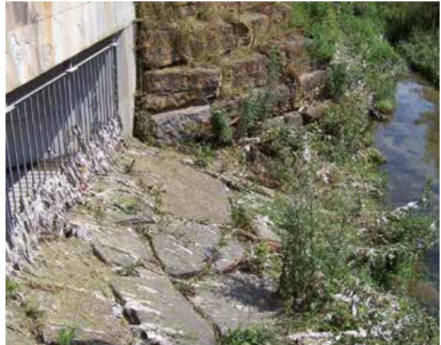
Typisches Bild eines Regenauslassbauwerkes ohne Grobstoffrückhalt nach einem Entlastungsereignis.
