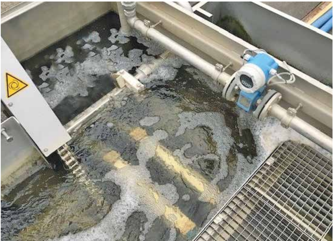
HUBER Tuchfilter RotaFilt® in Betrieb.
