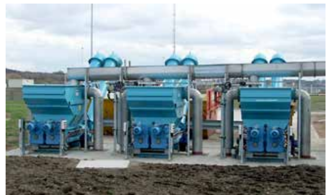
Großtechnische Anwendung: Schwemmrinnenbeschickung von HUBER Waschpressen WAP® L.
