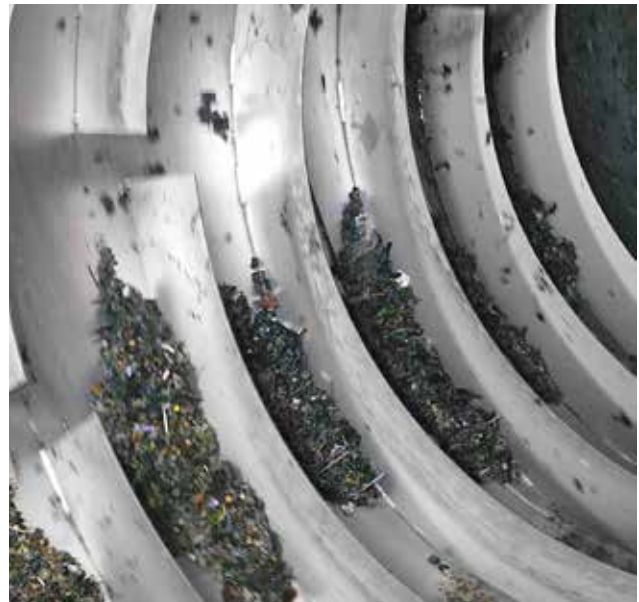
Pro Umdrehung 50 Liter abgeseibtes Rechengut.
