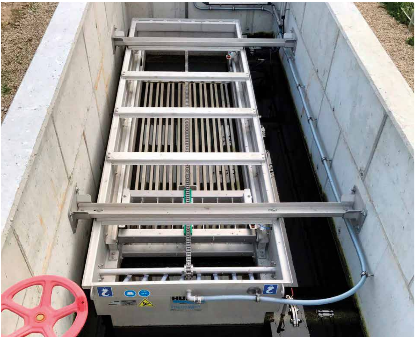
Einsatz des HUBER Abwasserwärmetauschers RoWin C im Betonbecken. Der Wärmeüberträger wird im Freispiegel durchströmt.
