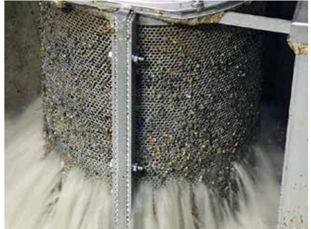
HUBER Schachtsiebzanlage ROTAMAT® RoK4 im Einsatz.
