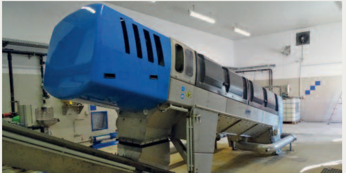
Nach dem Umbau: Komplette maschinelle Schlammwässerung mit HUBER Schneckenpresse Q-Press® 620
