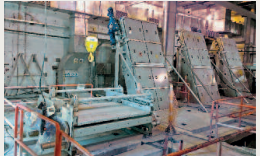
Aufgrund der Einbausituation der HUBER Lochblech-Umlaufrechen EscaMax® ist die enorme Baulänge von ca. 12 m nicht zu erkennen
