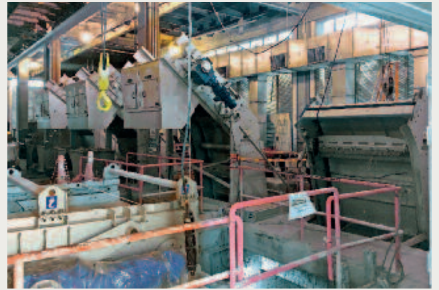
Die vier 12 m langen HUBER Grobrechen TrashMax® wurden wegen der beengten Platzverhältnisse zunächst in mehreren Teilen eingebracht und dann montiert
