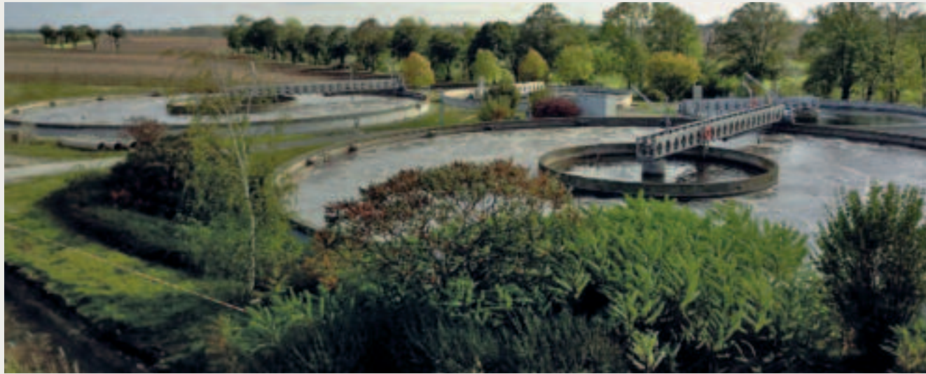
Abbildung 1: Auf der KA Straßfurt kann durch den Einsatz des HUBER CarbonWin® - Verfahrens mit Feinfiltrationstechnologie eine biologische Behandlungsstufe außer Betrieb genommen werden.
