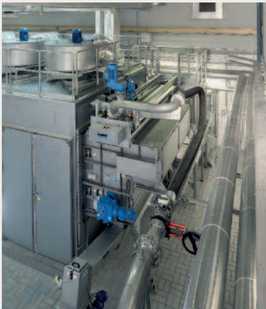
Schlammaufgabebereich und Trockenschlammabtransport am Kopfstück
