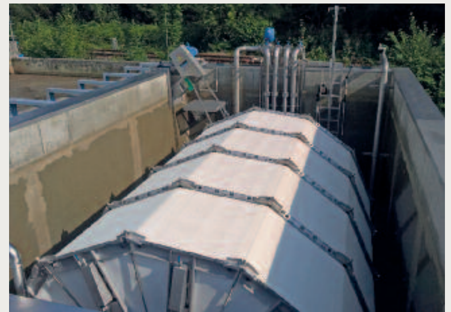
Die HUBER Membranfiltration VRM® 50 vor der Inbetriebnahme
