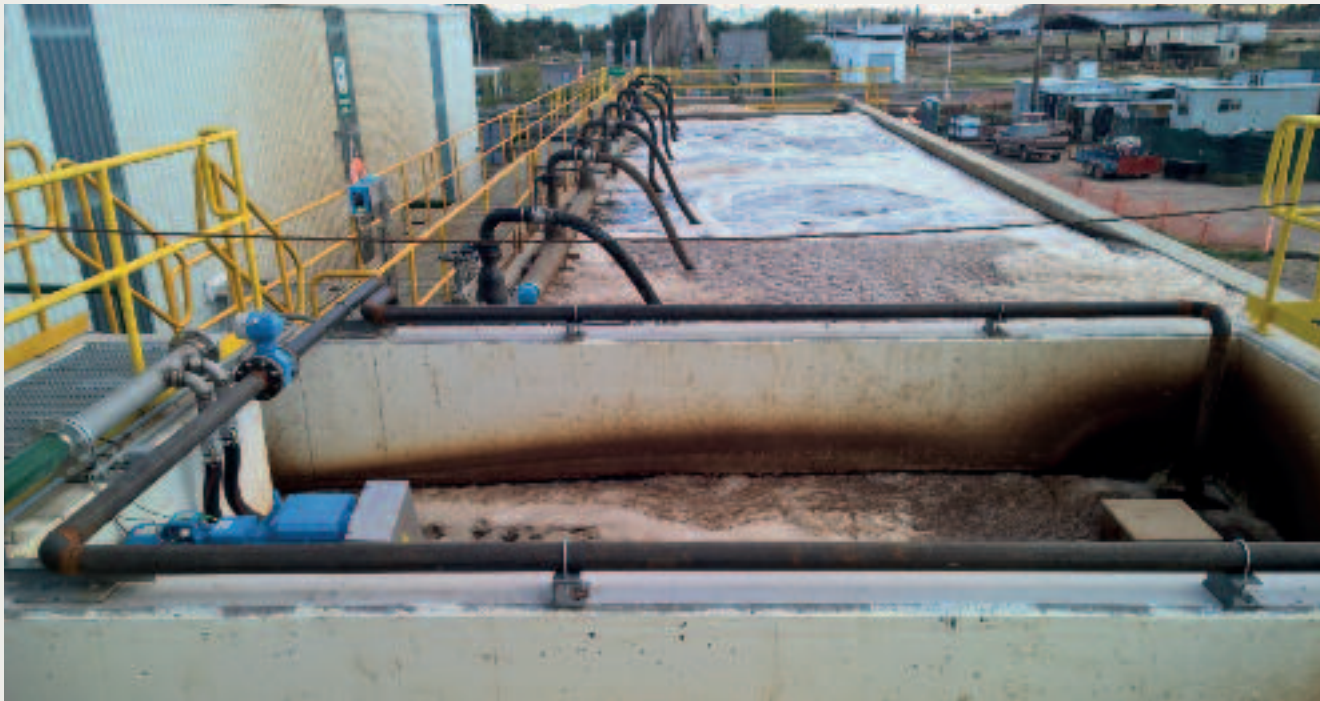
Übersicht Abwasserreinigungs- und Recyclinganlage Masisa S. A. Durango
