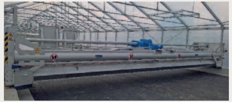
Der HUBER Schlammwender SOLSTICE® kurz vor der Inbetriebnahme
