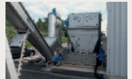
Die HUBER Waschpresse WAP® sorgt im Anschluss an den HUBER Harken-Umlaufrechen RakeMax® zuverlässig für eine optimale Kompaktierung des Rechengutes
