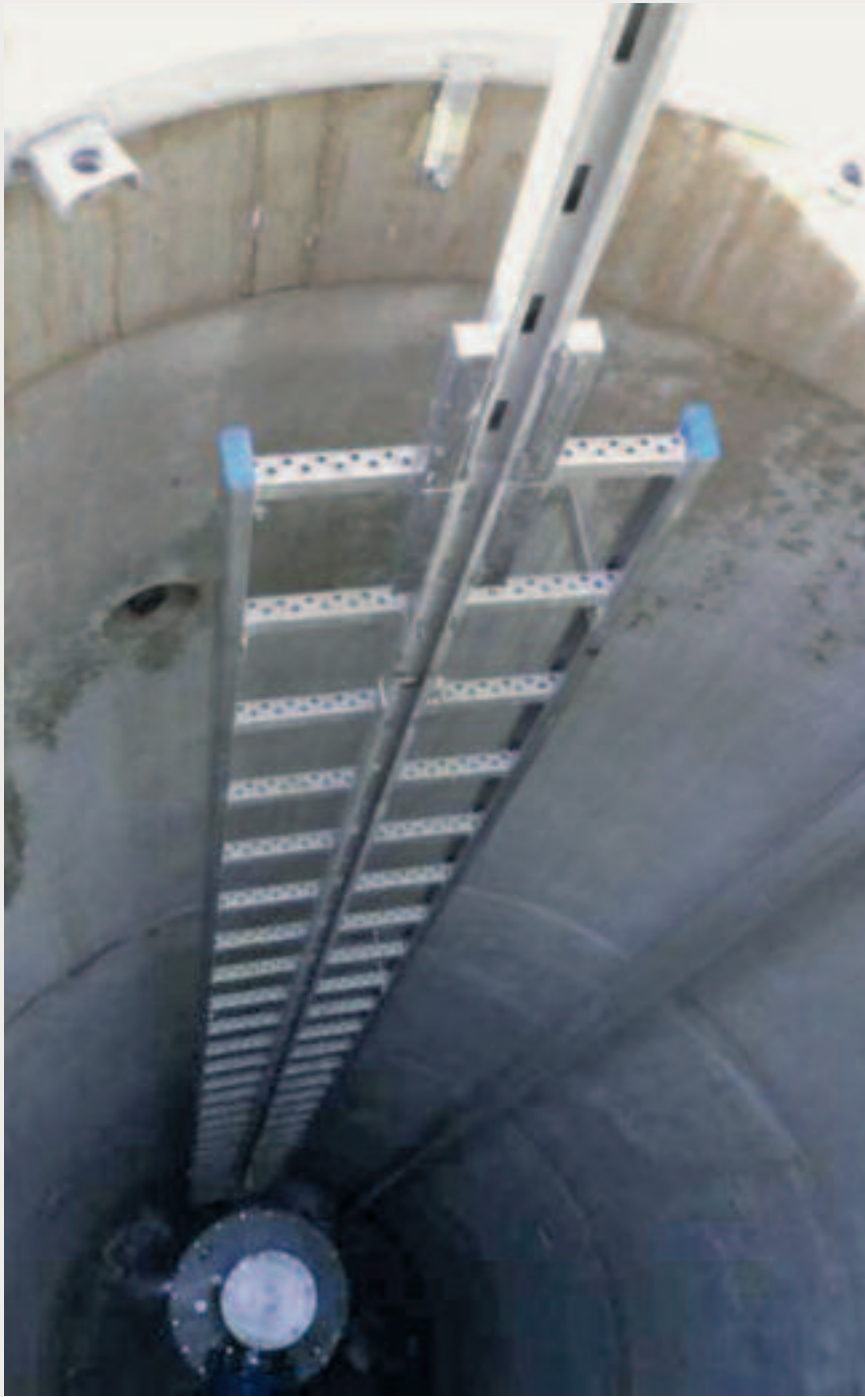
Sicheres Begehen: Leiter mit Sicherheitsfallschutzschiene
