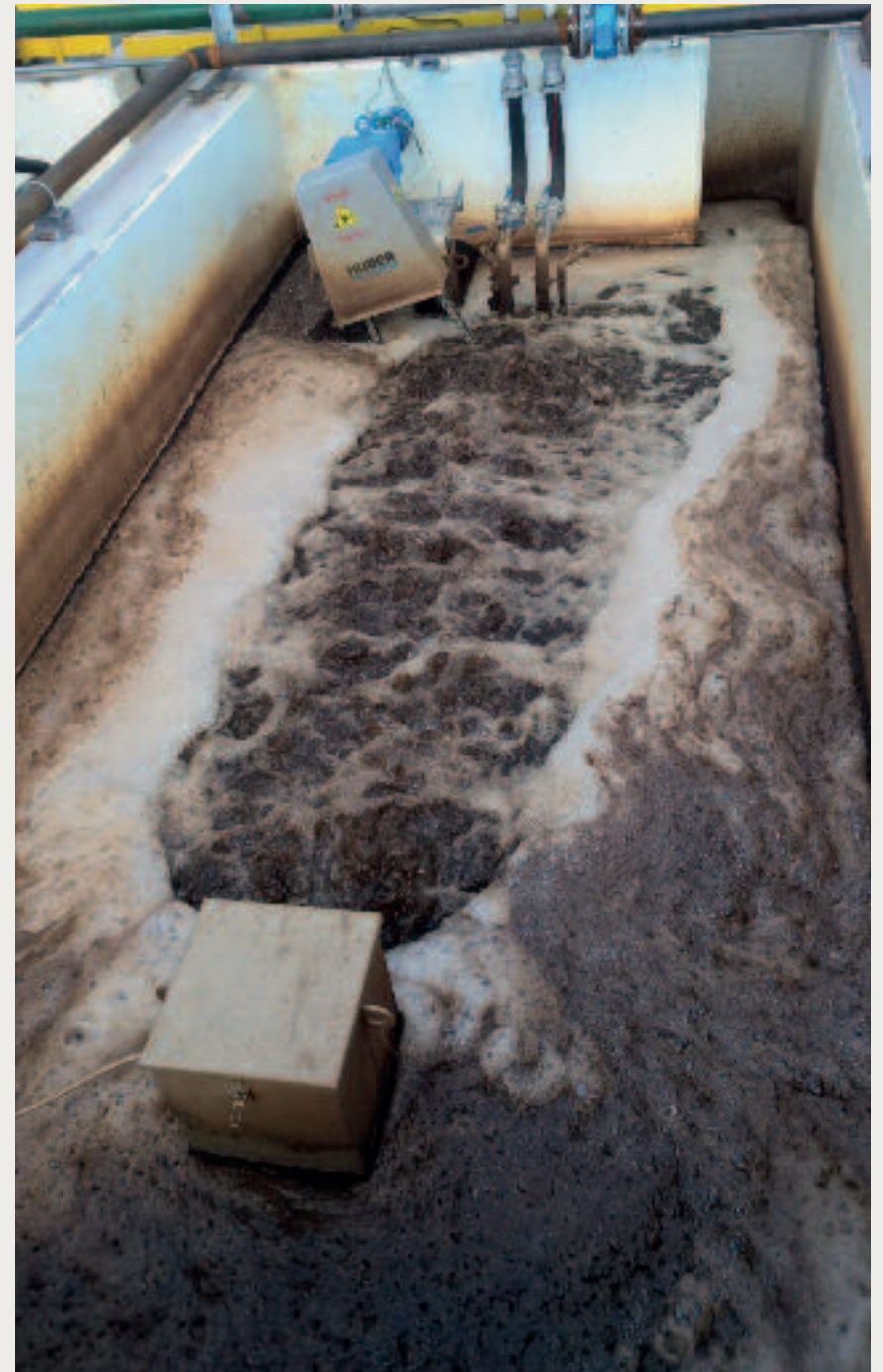
Filtrationskammer der HUBER Membranfiltration VRM® 20
