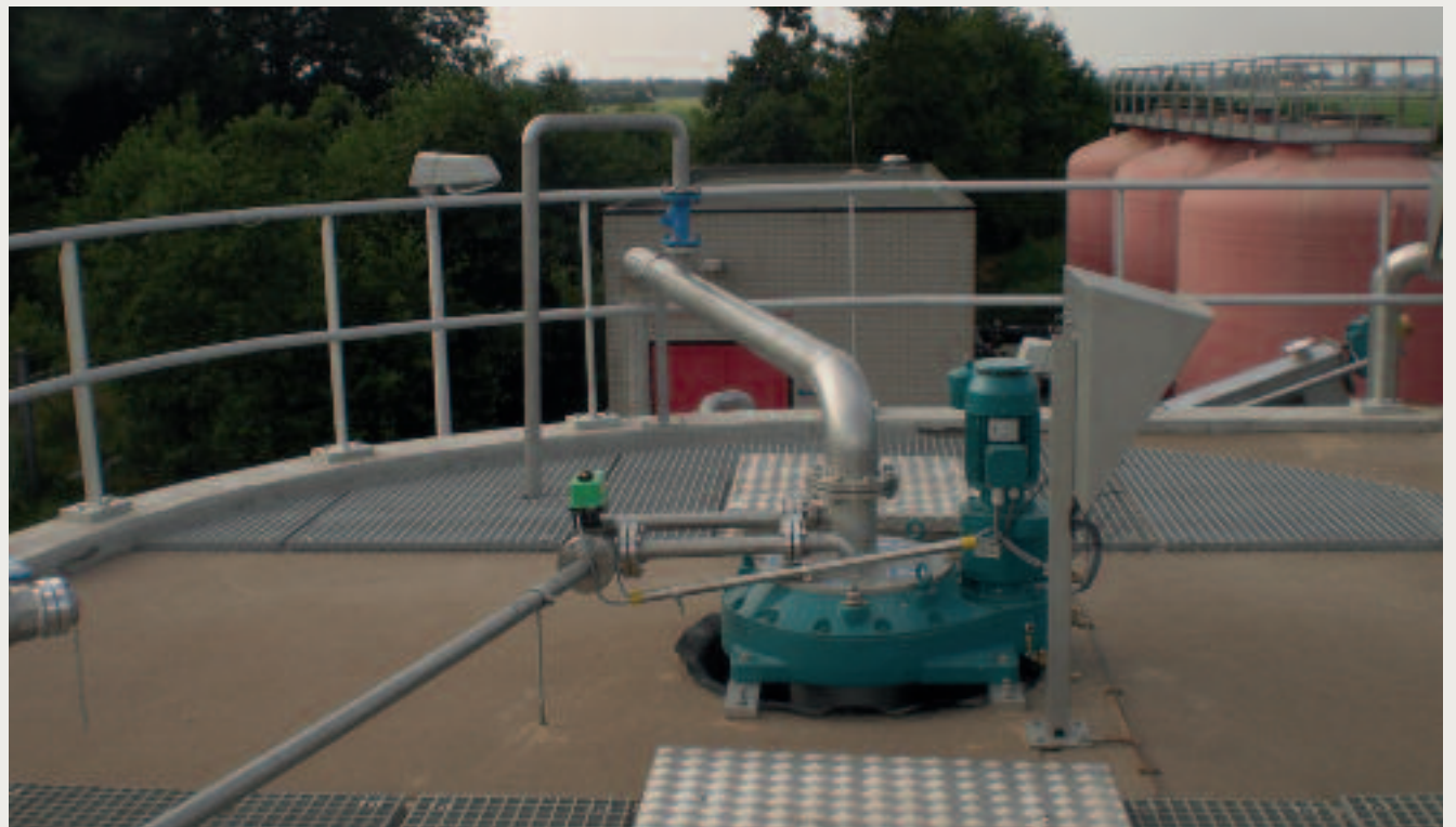
Flaches Land - feiner Sand - super Abscheideergebnis: Der HUBER Rundsandfang VORMAX überzeugt auf Kläranlagen in den Niederlanden
