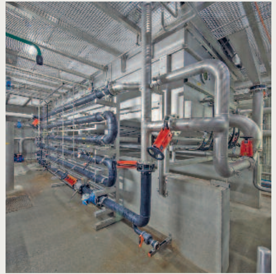
HUBER Druckentspannungsflotation HDF behandelt Abwässer der Käseproduktion
