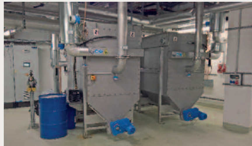
Abbildung 1: Parallele Aufstellung der HUBER Abwasserwärmetaucher RoWin in der Heizzentrale des Museums in Regensburg
