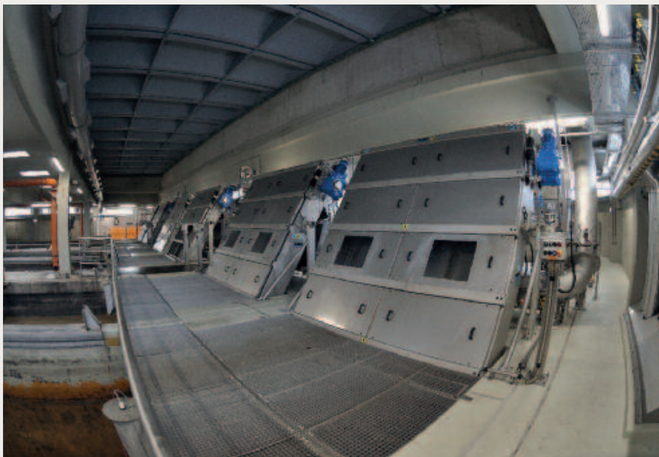
Hauptkläranlage Wien: HUBER Harken-Umlaufrechen RakeMax® Hybrid als Feinrechen mit Spaltweite 3 mm und erhöhter Rechenrostfläche durch einen Aufstellwinkel von 60° im Auslaufbereich des Sandfanges
