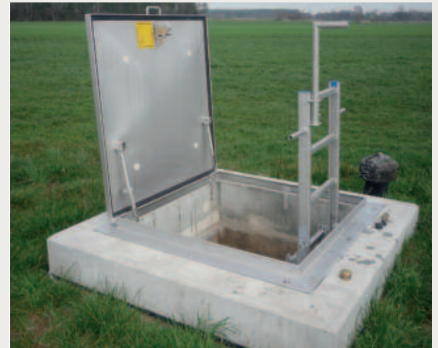
Sichere Ausrüstung: Schachtabdeckungen, Sicherheitssteigleiter und Einsteighilfe
