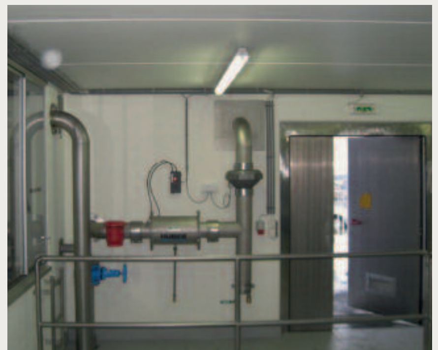
Abbildung 4: Einsatzbeispiel der „Aktiven Zwangsbelüftung“ am HB Utzenaich in Österreich
