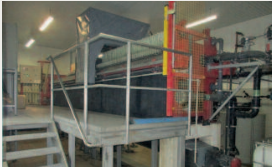
Vor dem Umbau: Schlammwässerung mit Kammerfilterpresse
