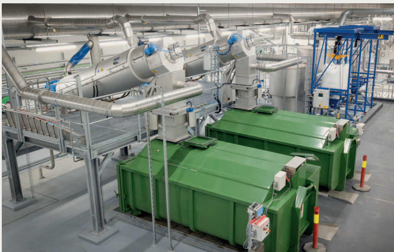
Die Schlammwässerung erfolgt durch diese beiden HUBER Schneckenpresse S-PRESS
