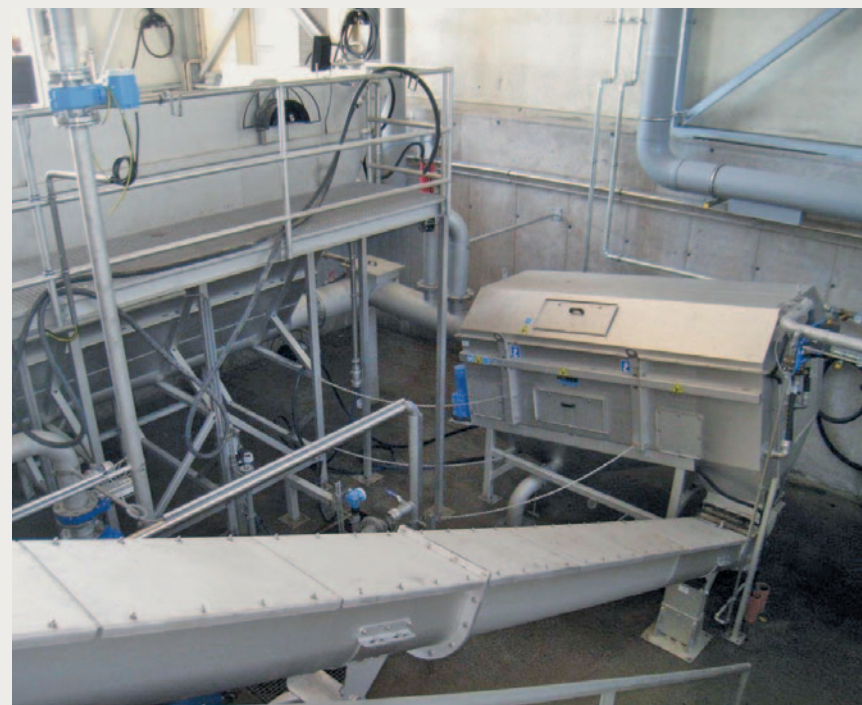
Das HUBER Sandaufbereitungsverfahren RoSF5 kurz nach Inbetriebnahme – Annahmehunker RoSF7 mit Waschtrommel RoSF9 zur Grobstofftrennung und angrenzender Förderschnecke RoSF13 Tag.
