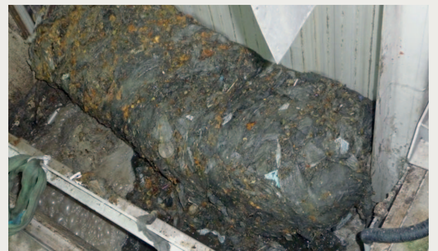
Beispiel einer Rechengutwalze bei Spülstoßbeginn - kein Problem für den TrashLift
