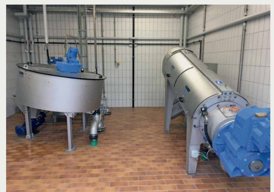
Eindickung und Entwässerung aus einer Hand mit dem HUBER Scheibeneindicker S-Disc und der HUBER Schneckenpresse Q-PRESS®
