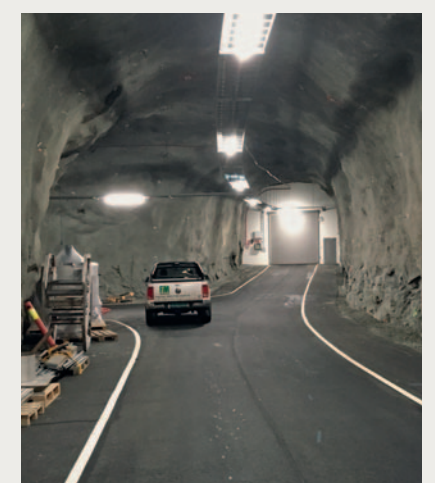
Wie viele skandinavische Kläranlagen befindet sich auch diese in einem Tunnel
