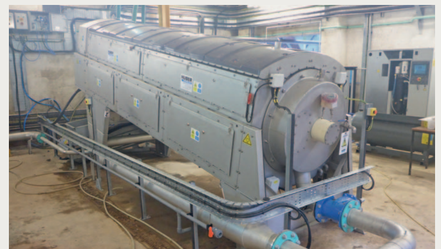
Bild 2: HUBER Schneckenpresse Q-PRESS® 800.2 im Bestandssystem während der Installation
