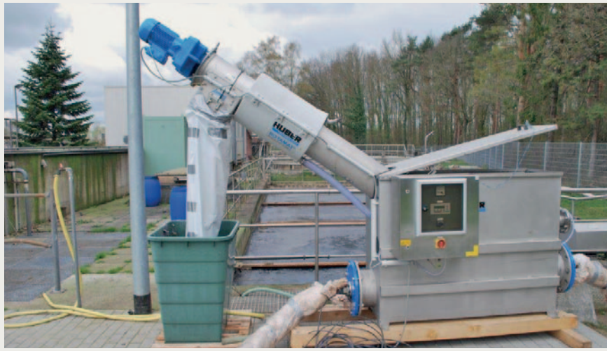
HUBER Siebanlage ROTAMAT® Ro9 – Versuchsanlage zur Siebung von Schlammfiltratwasser
