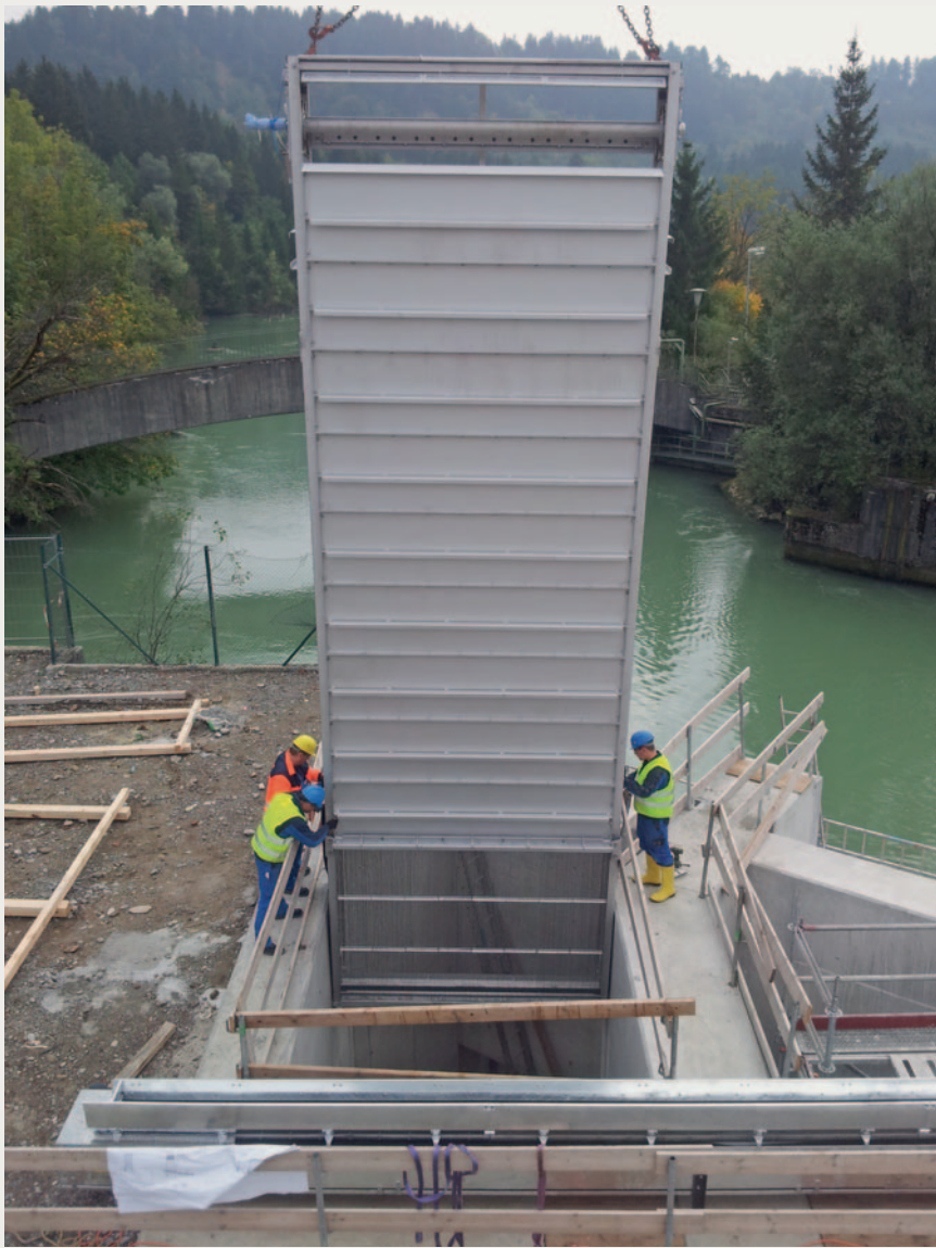
Abbildung 1: Einbau HUBER Harken-Umlaufrechen RakeMax® für eine Flusswasserentnahme
