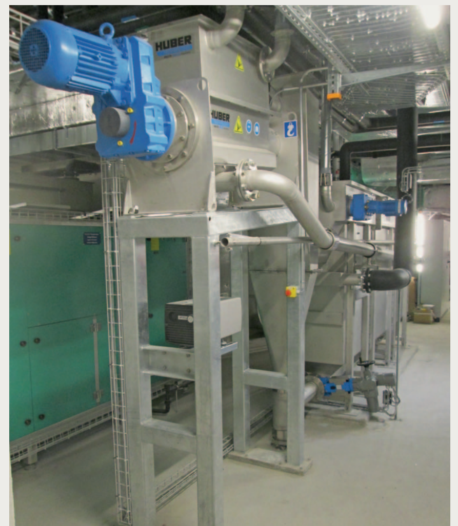
Vorsiebung (6 mm) des Abwassers mit HUBER Waschpresse WAP®
