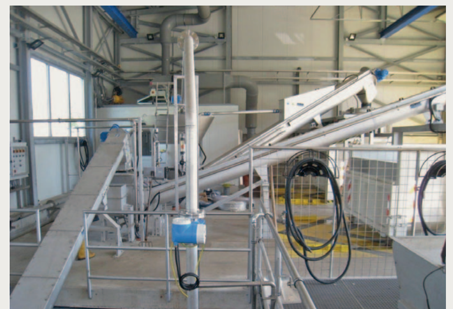
HUBER Sandwaschanlage RoSF4 als Kernstück des Gesamtverfahrens. Ergebnis ist eine Sandqualität mit einem Glühverlust kleiner als drei Prozent
