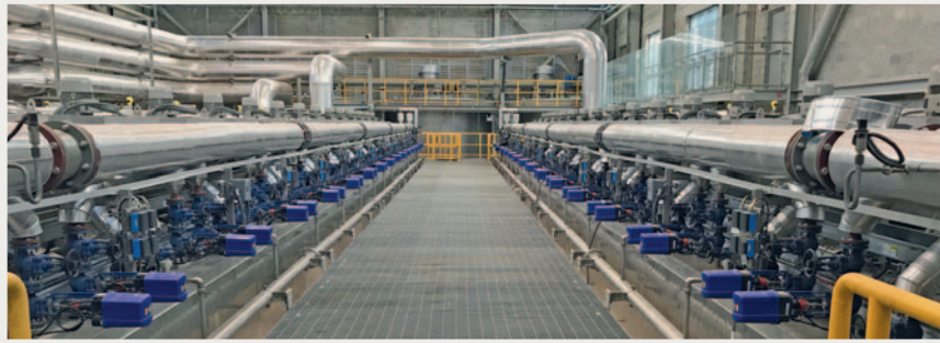
Wartungsbühne und Wärmeversorgung
