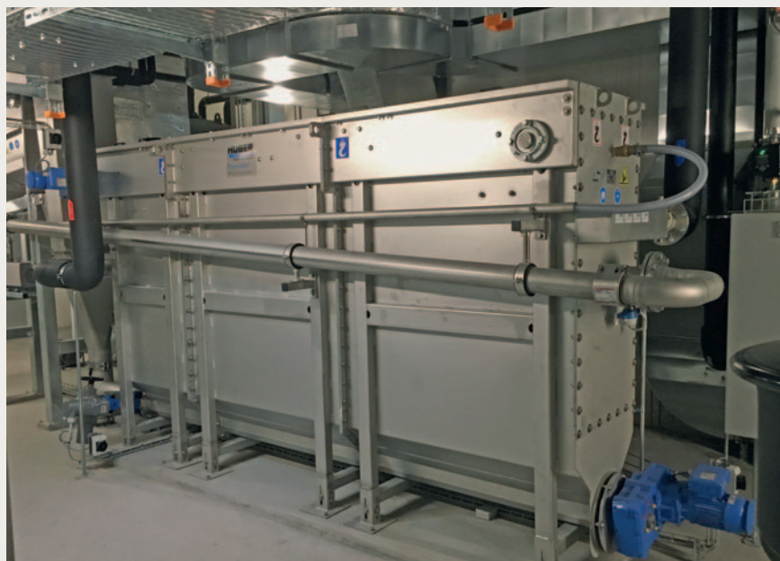
HUBER Wärmetauscher RoWin im Technikraum des Valsana
