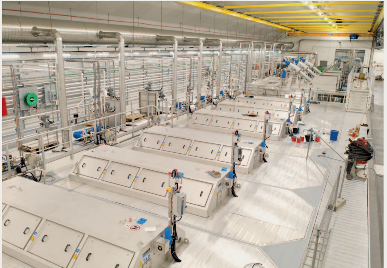
HUBER Komplettlösung installiert und betriebsbereit
