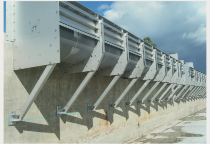
Großtechnische Siebung eines Mischwasserabschlagbauwerks mit der HUBER Siebanlage ROTAMAT® RoK1
