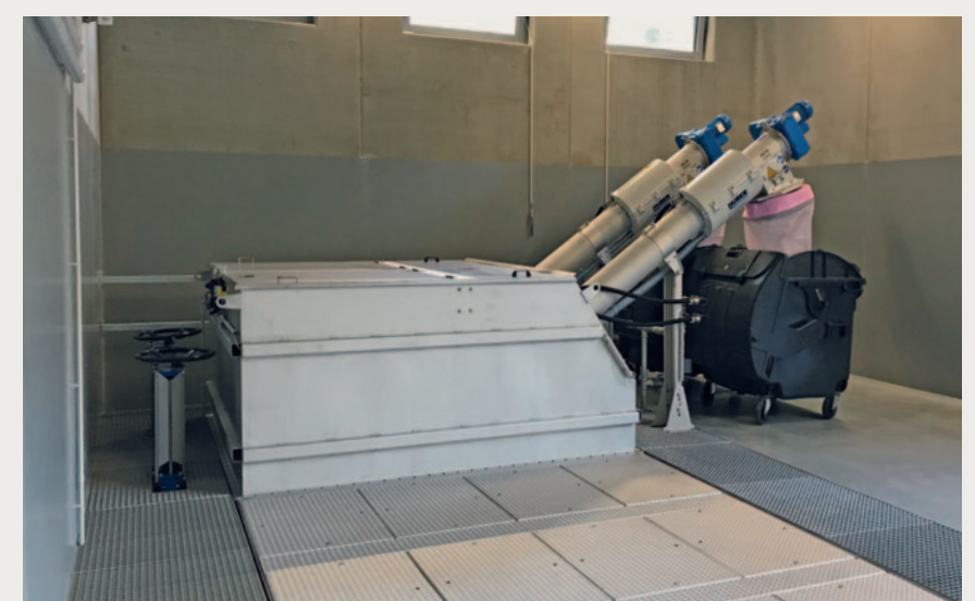
Eine große unterirdische HUBER Kompaktanlage Hydro Duct ROTAMAT® mit zwei HUBER Siebanlagen ROTAMAT® Ro2
