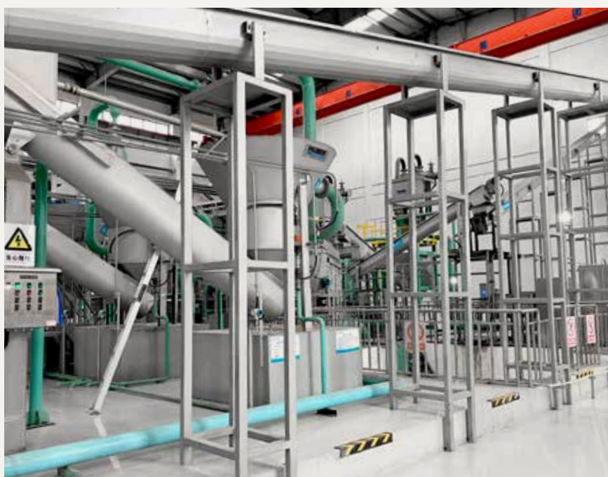
HUBER Coanda Sandwaschanlage RoSF4 als wichtigste Komponente im Sandaufbereitungsprozess in Wuhan.
