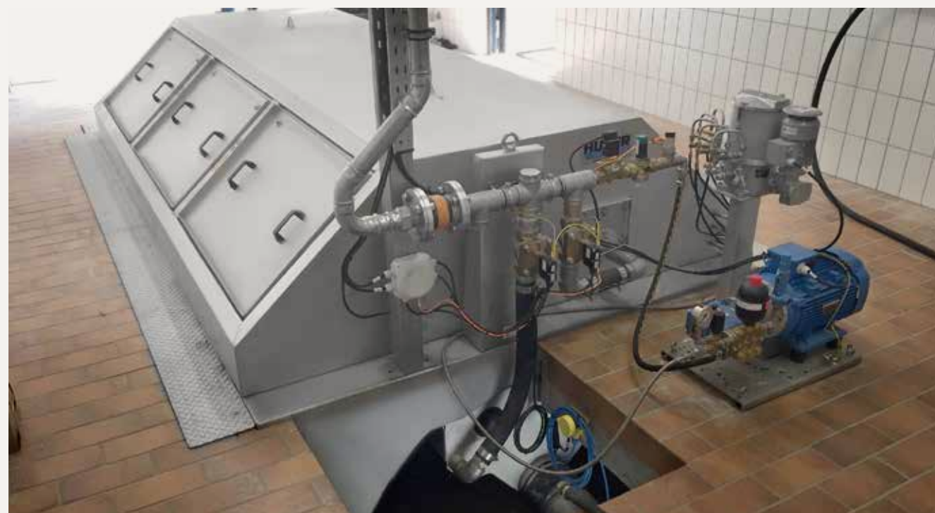
KA Vohburg: HUBER Trommelsieb LIQUID als Alternative zum Vorklärbecken für 360 m 3 /h auf geringstem Bauraum.
