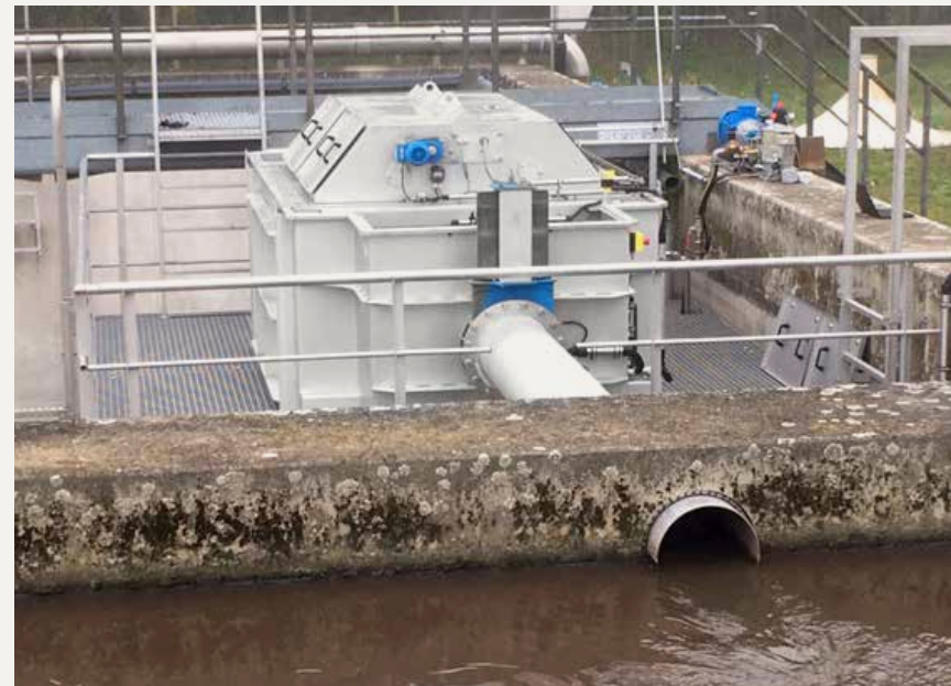
KA Kahla: HUBER Trommelsieb LIQUID als Vorklärbeckenersatz in einem stillgelegten Betonbecken installiert.
