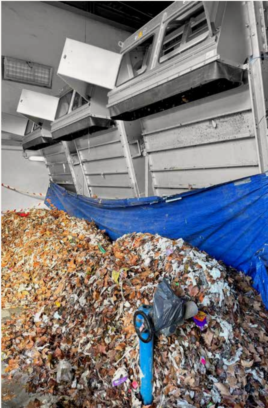
Beseitigtes Rechengut nach dem größten Regenereignis. Die HUBER RakeMax® in Arroyofresno nach der Montage.
