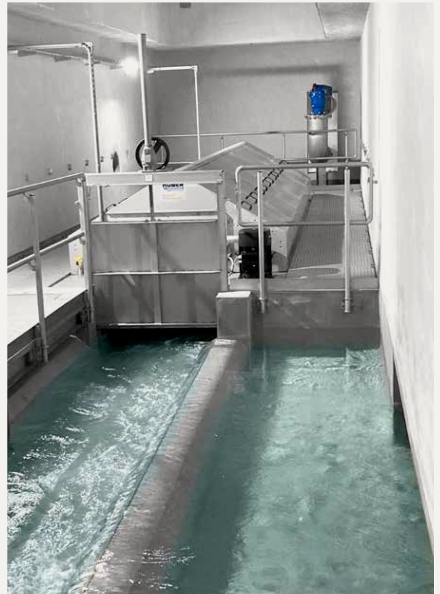
Umgesetzte Großanwendung im Bereich Uferfiltratwasser-Mikrosiebung.
