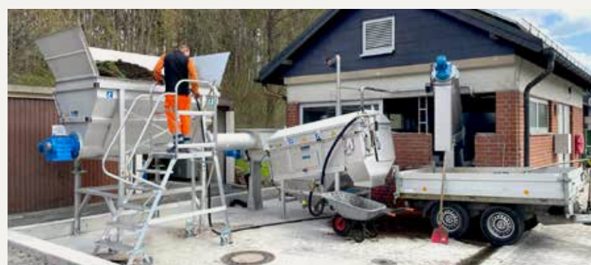
Der Annahmehbereich des HUBER Sandaufbereitungsverfahrens, bestehend aus HUBER Sanddosierschnecke RoSF7 inkl. Annahmehunker und einer HUBER Waschtrommel RoSF9.
