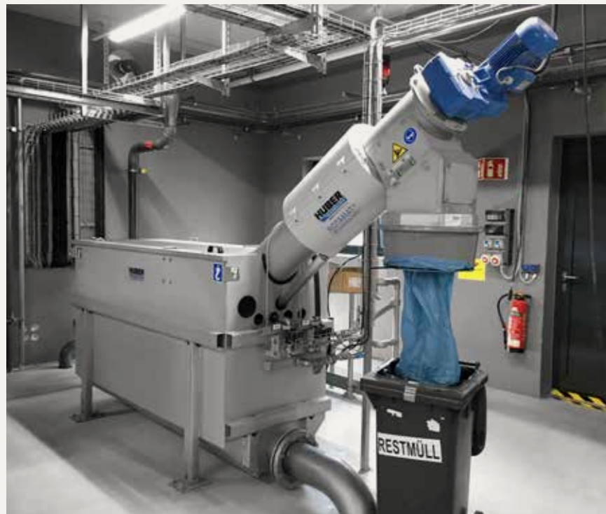
HUBER Siebanlage ROTAMAT® RPPS 780/2 im Behälter zur Vorreinigung des Abwassers aus der Produktion.
