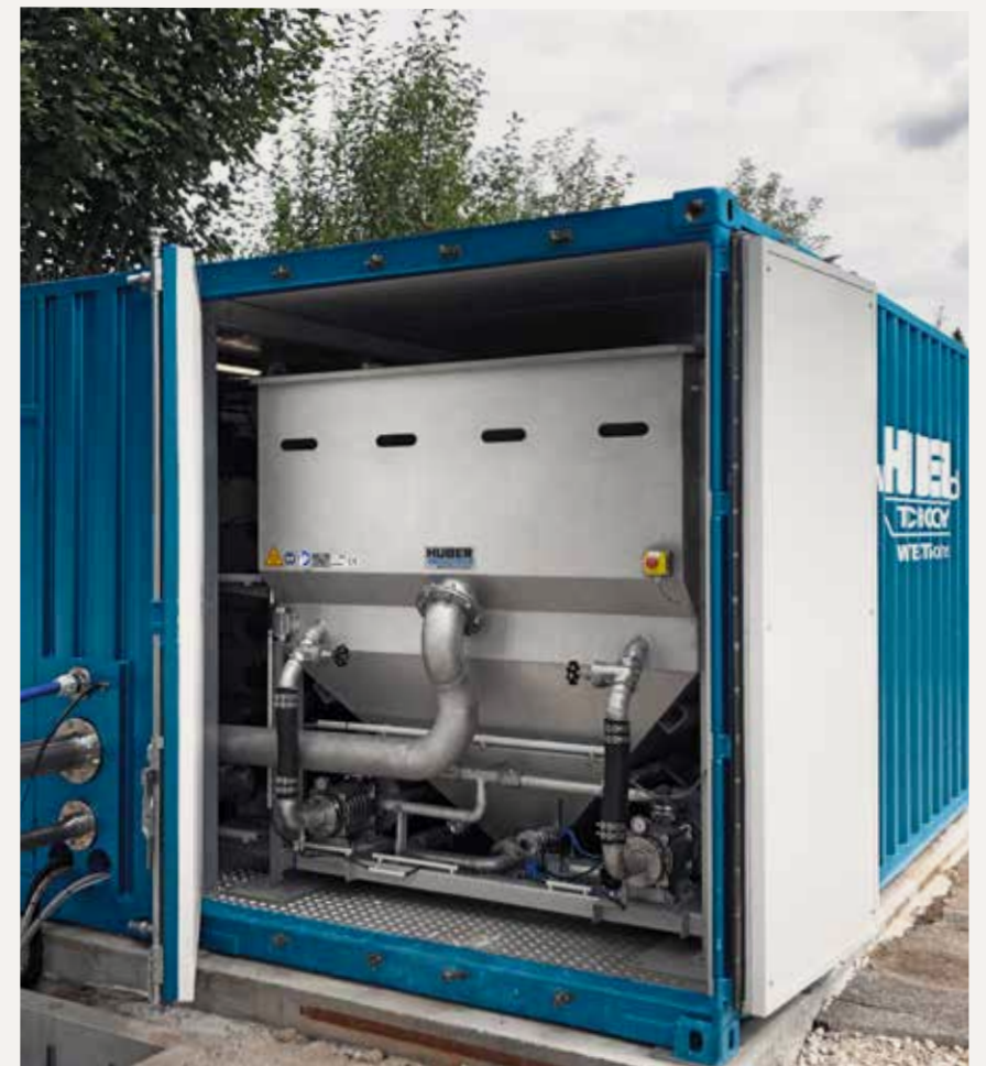
HUBER Druckentspannungsflotation HDF S4 im 2 x 20 ft-Doppelcontainer in der Milchindustrie.
