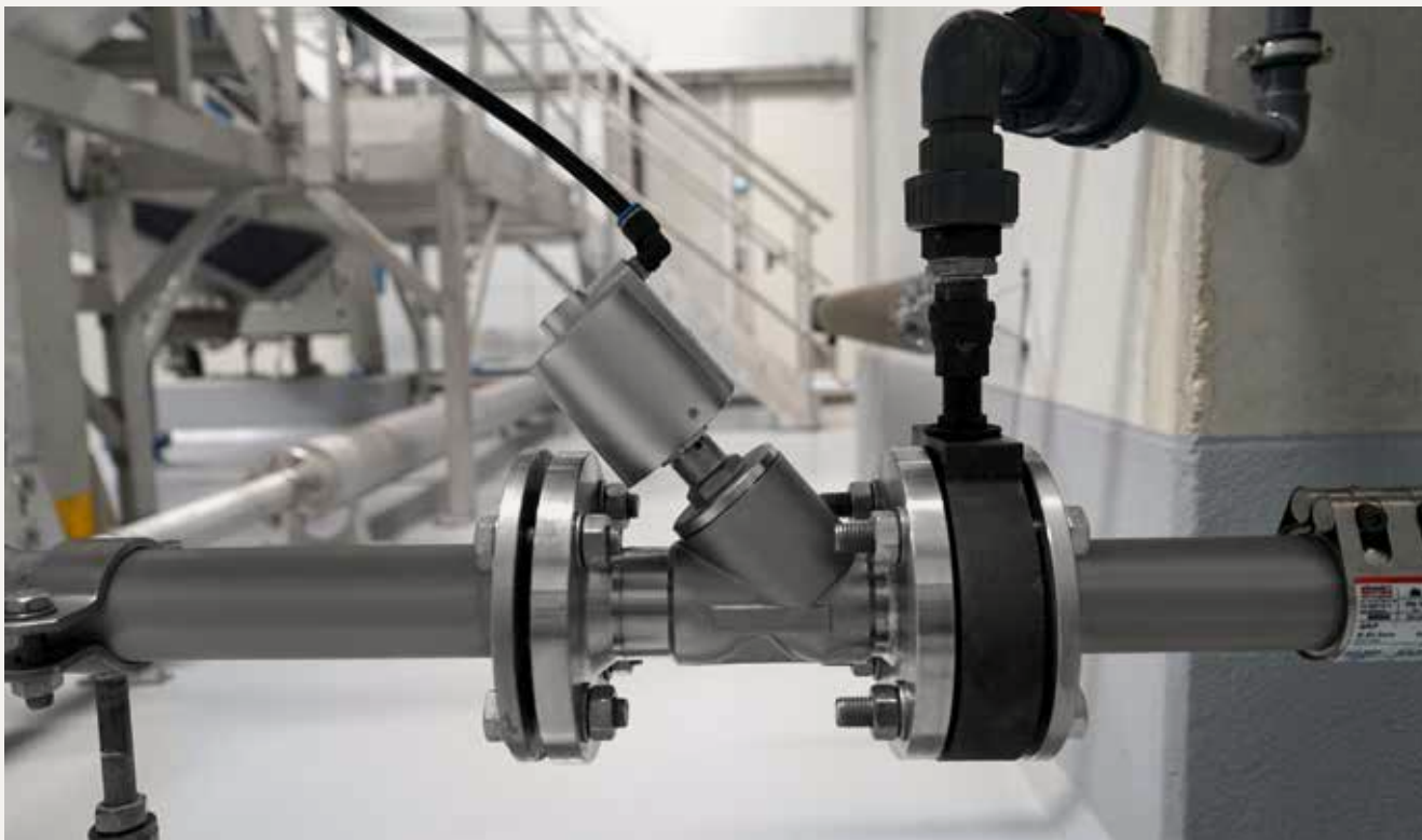
Automatisiertes Mischventil aus Edelstahl mit vorgeschaltetem Flockmittelimpfing.
