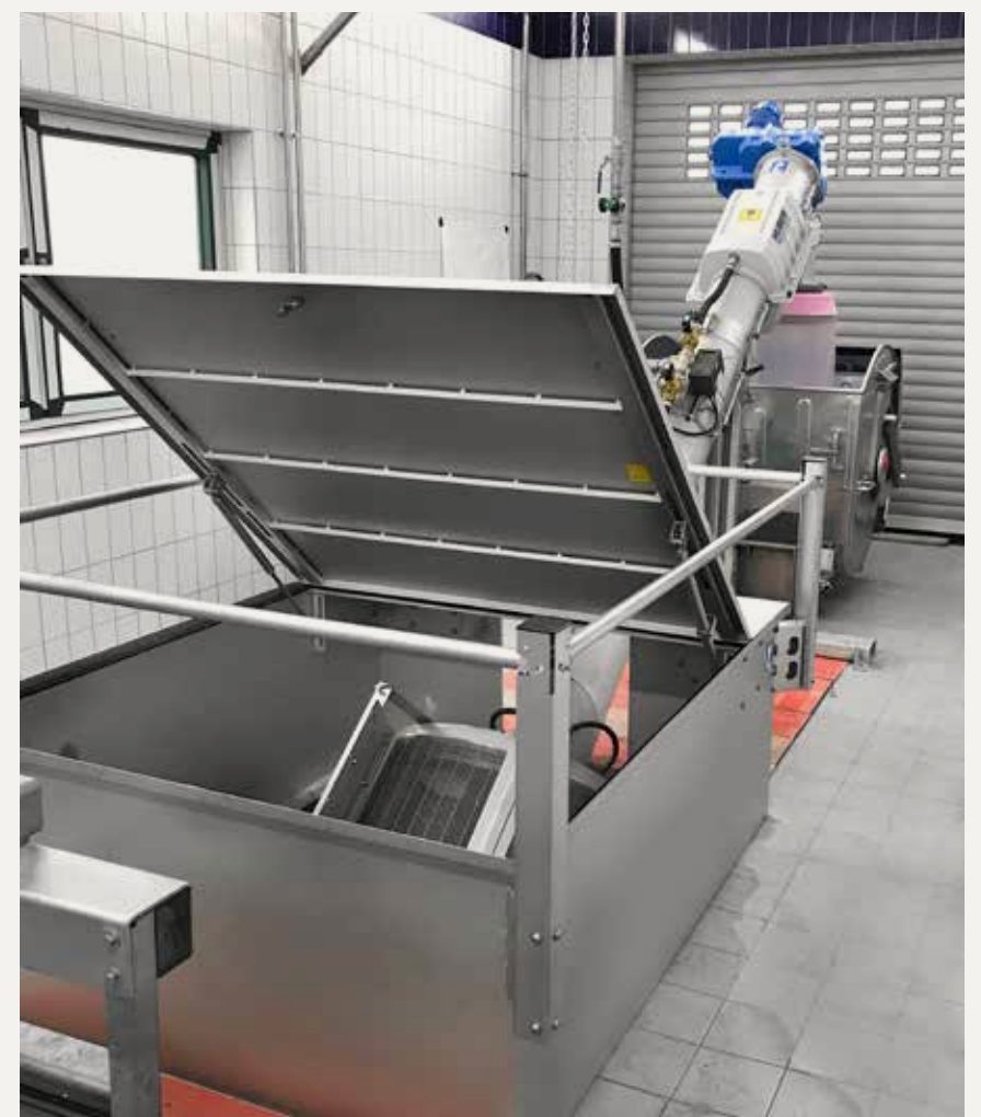
Die neu eingebaute HUBER Siebanlage ROTAMAT® Ro2 auf der KA Brannenburg.
