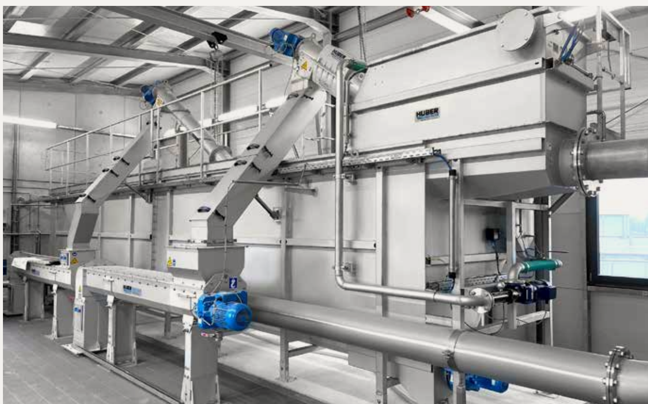
HUBER Kompaktanlage ROTAMAT® Ro5 (80 l/s) mit HUBER Siebanlage ROTAMAT® Ro2, Sand- und Fettfang.
