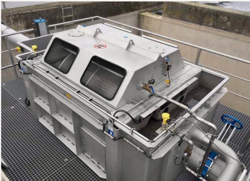
KA Kahla: Kompaktes HUBER Trommelsieb LIQUID System für max. Reduktionsleistungen AFS/CSB.
