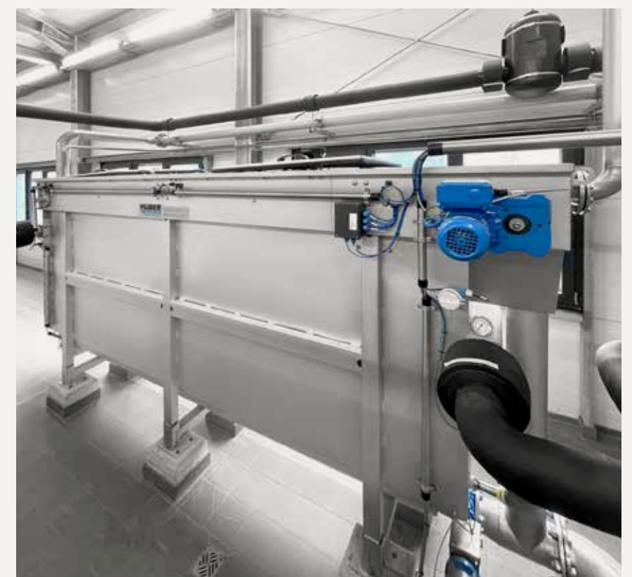
HUBER Abwasserwärmetauscher RoWin, das Herzstück zur Rückgewinnung von Energie aus Abwasser.
