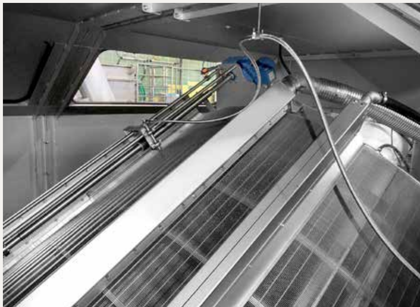
Zwei HUBER Siebanlagen ROTAMAT® Ro2 auf der Kläranlage Salzburg Siggerwiesen. Die Maschinen mit 2,6 m großen Siebkörben sind in zwei parallelen Gerinnen verbaut.
