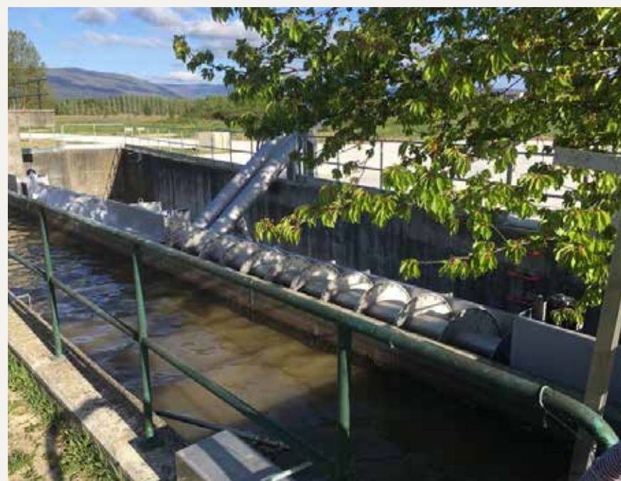
Lösung in Spanien: HUBER Siebanlage ROTAMAT® RoK1 mit Querförderschnecke für den Siebgutauswurf direkt in einen Container.
