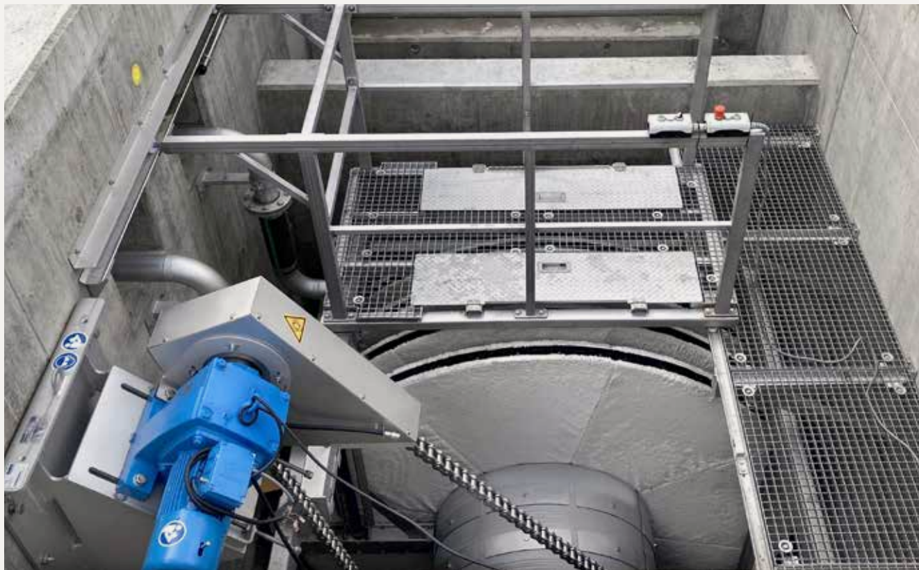
Flockungsfiltration mit dem HUBER Tuchfilter RotaFilt® 2700 auf der Kläranlage Kreßberg.
