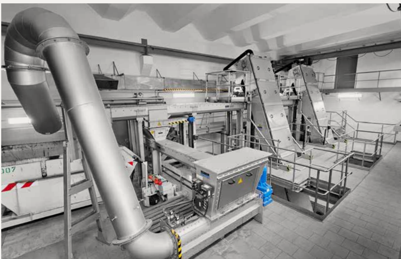
2 HUBER Harken-Umlaufrechen RakeMax®, 3 HUBER Trogförderschnecken Ro8 T und 1 HUBER Waschpresse WAP® im Pumpwerk Dierkow.
