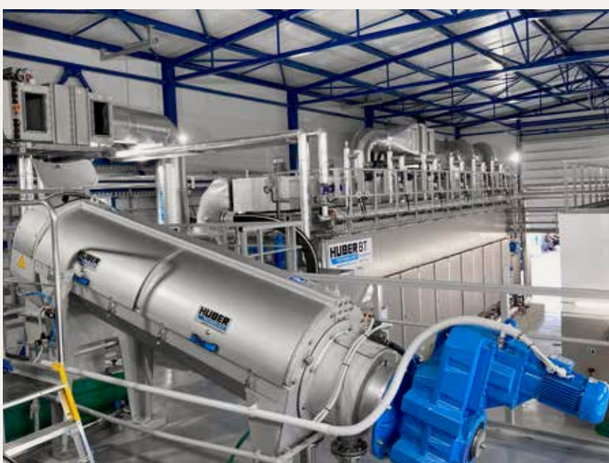
Die HUBER Schneckenpresse Q-PRESS® 440.2 entwässert den Schlamm, der HUBER Bandtrockner BT 12 trocknet den entwässerten Schlamm anschließend.
