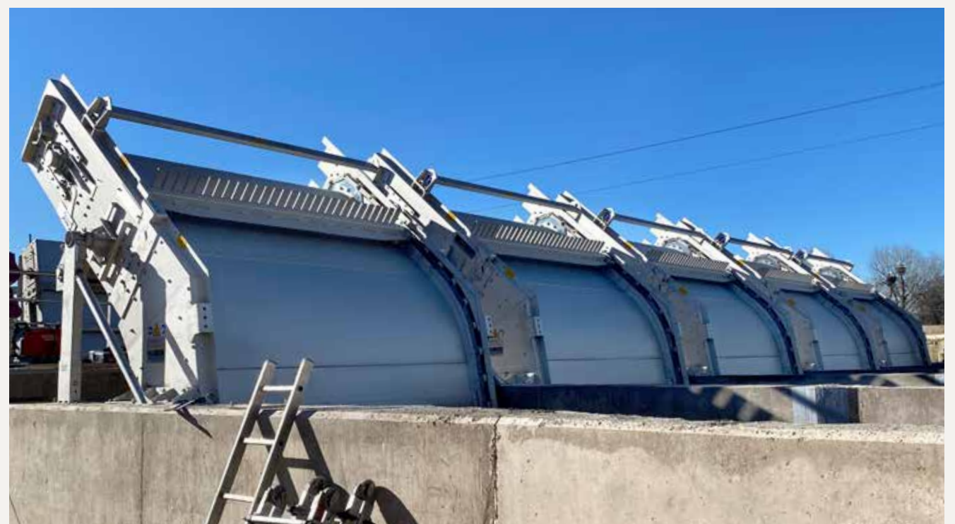
Die eingebauten 5 HUBER Grobrechen TrashMax® bei EDAR SUR.
