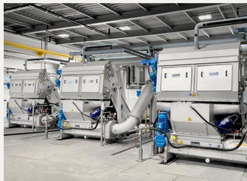
Die drei HUBER Waschpressen WAP® SL 8 zur Rechengutbehandlung nach den Feinrechen.
