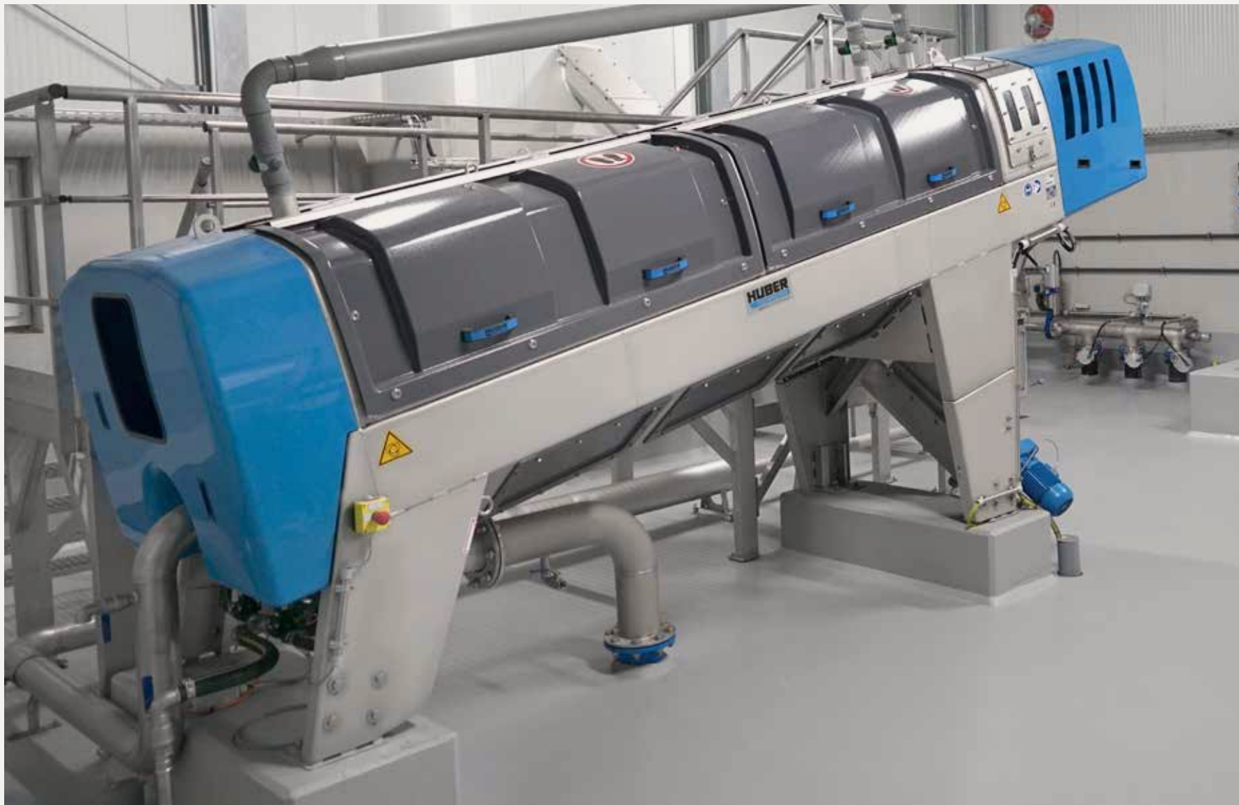
Die HUBER Schneckenpresse Q-PRESS® 620.2 auf der Kläranlage Beilngries.
